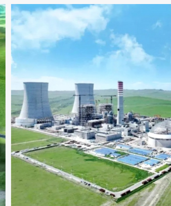
新型高效灵活1000兆瓦等级褐煤电站锅炉
