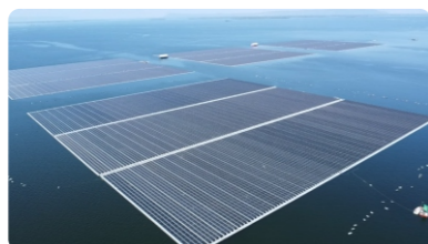
泰国乌汶叻(Ubolratana)水面漂浮光伏电站项目
